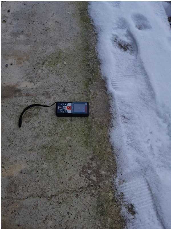
Фото 9. Угол наклона отмостки
